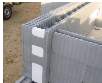
Устраивая дверные и оконные проемы и окончания стен – отверстия в опалубке прикрываем элементами ОН, ОВ и ОС.
