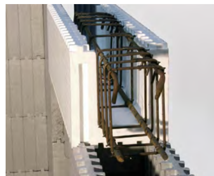
En el componente de dintel ML se pone la armadura muy fácilmente.
